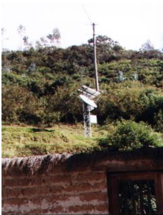
Foto 4: Detalle panel solar para teléfono público de Huancacalle
