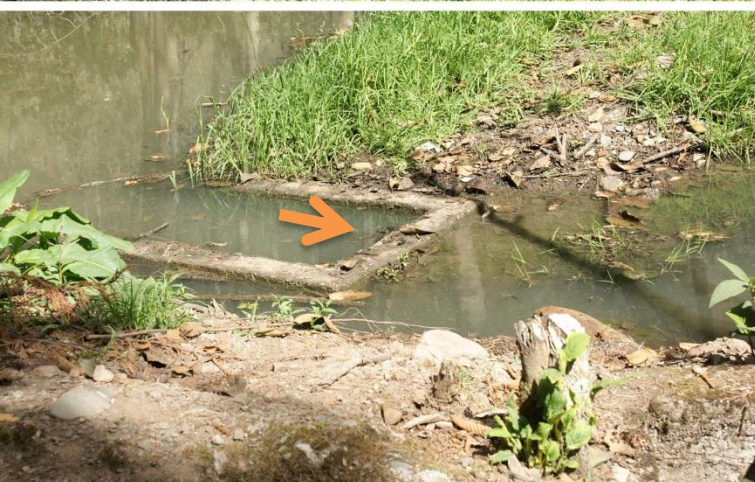
Saneamento existente colapsado na localidade de Lucma
